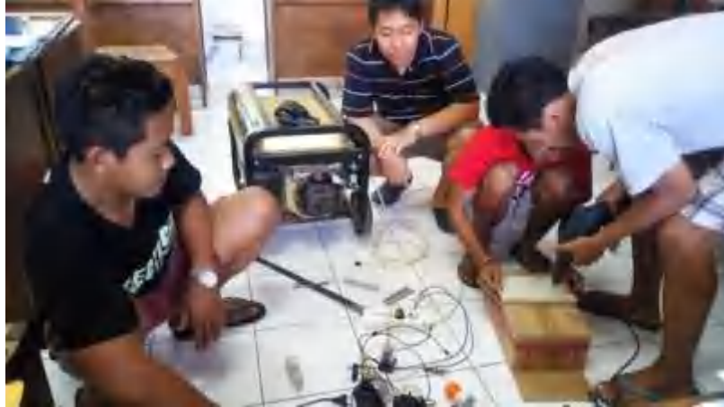
Gambar 3. Proses Perakitan Rangkaian AMF ATS
